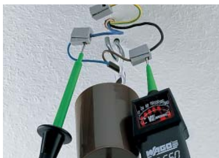
Проверка напряжения в клеммах для светильников
